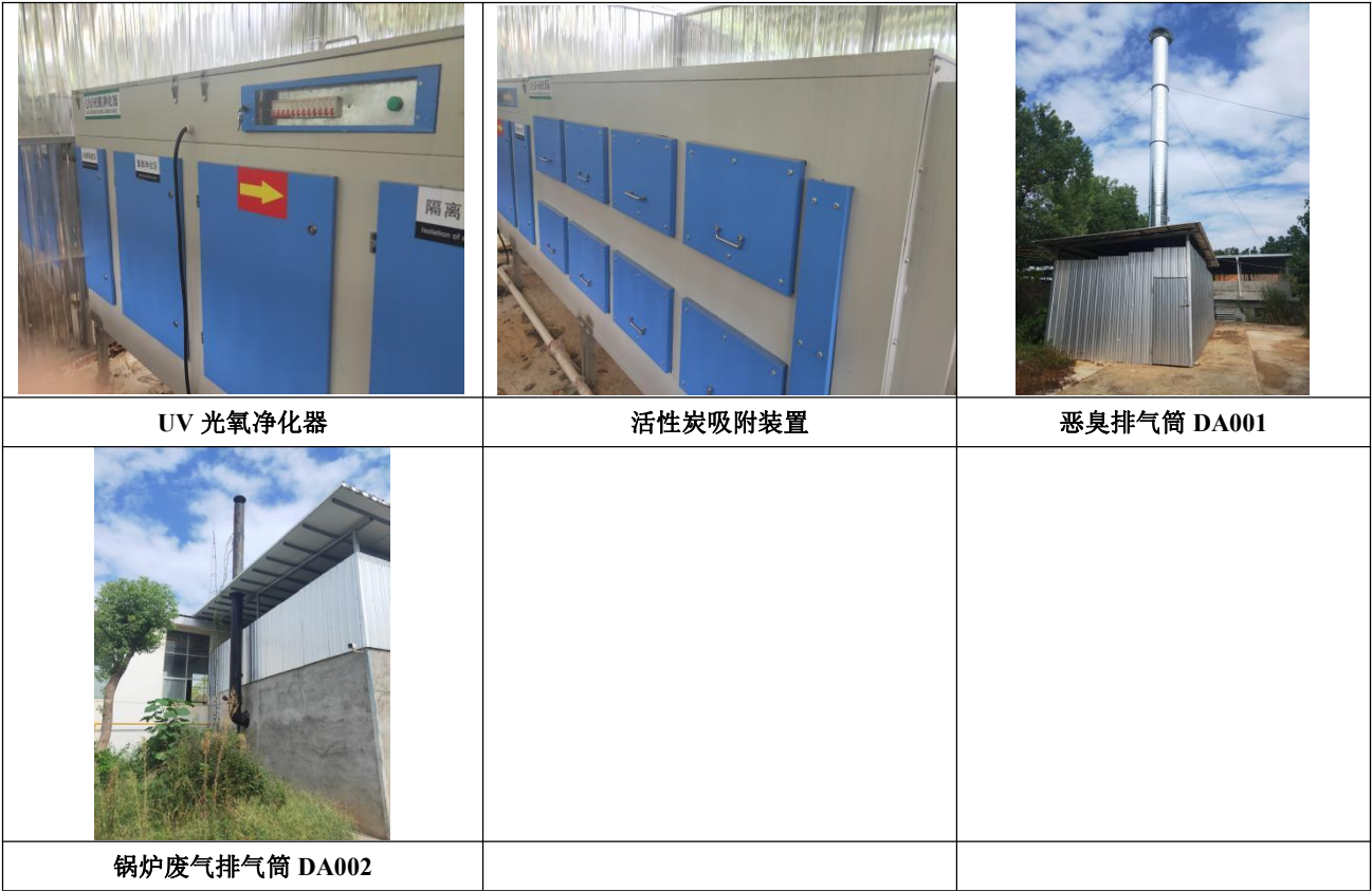
图 4-1-4 项目废气处理设施图片
